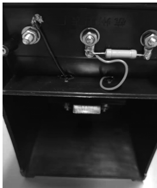
图 8 接线柱背面放大
